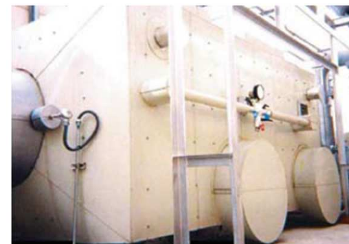
脱硝装置外観
