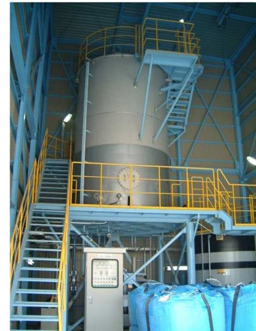
尿素溶解設備
